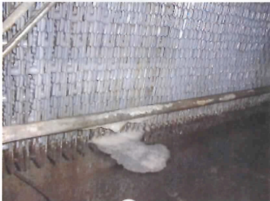
クーリングタワー内部 (98. 12. 21)
